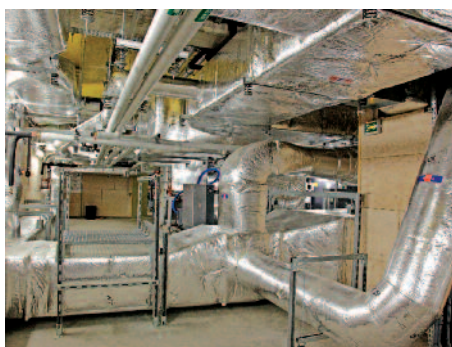
Centrale de traitement d'air de la salle blanche
